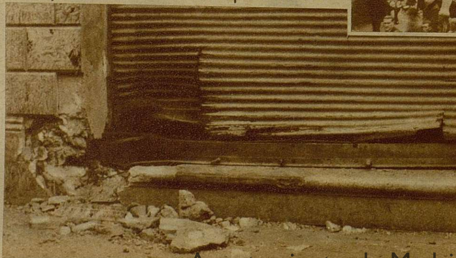
En una oficina electoral de Melilla, un grupo de individuos, cuya personalidad se desconoce, colocó un petardo, cuya explosión causó gran alarma en el vecindario. El cierre metálico y la parte inferior de la fachada sufrieron daños de escasa importancia (Foto Zarco)
